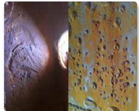
Sin prep superf. rev. tanque Corrosión por bacteria
